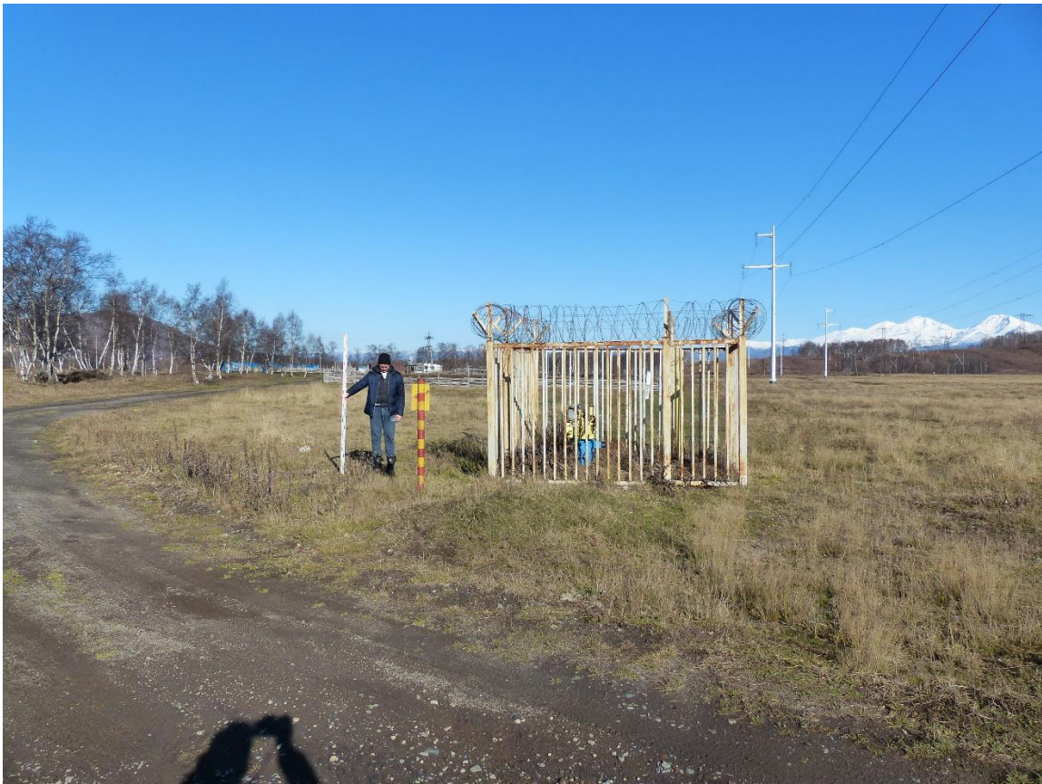
Рис. 39. Компрессорная установка на трассе газопровода. Вид с юго-запада.
