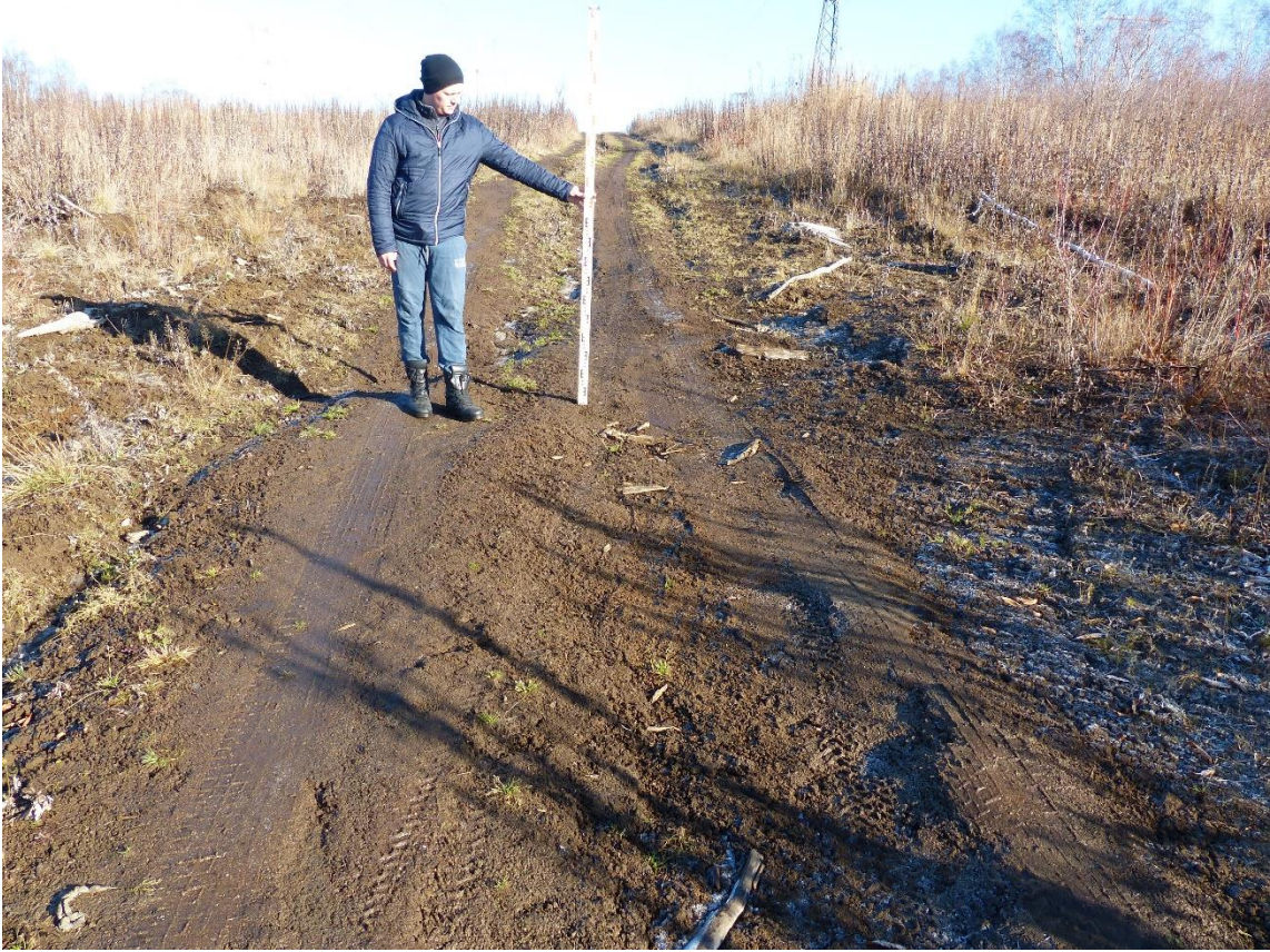
Рис. 20. Осмотр дорожной колеи. Вид с юго-запада.
