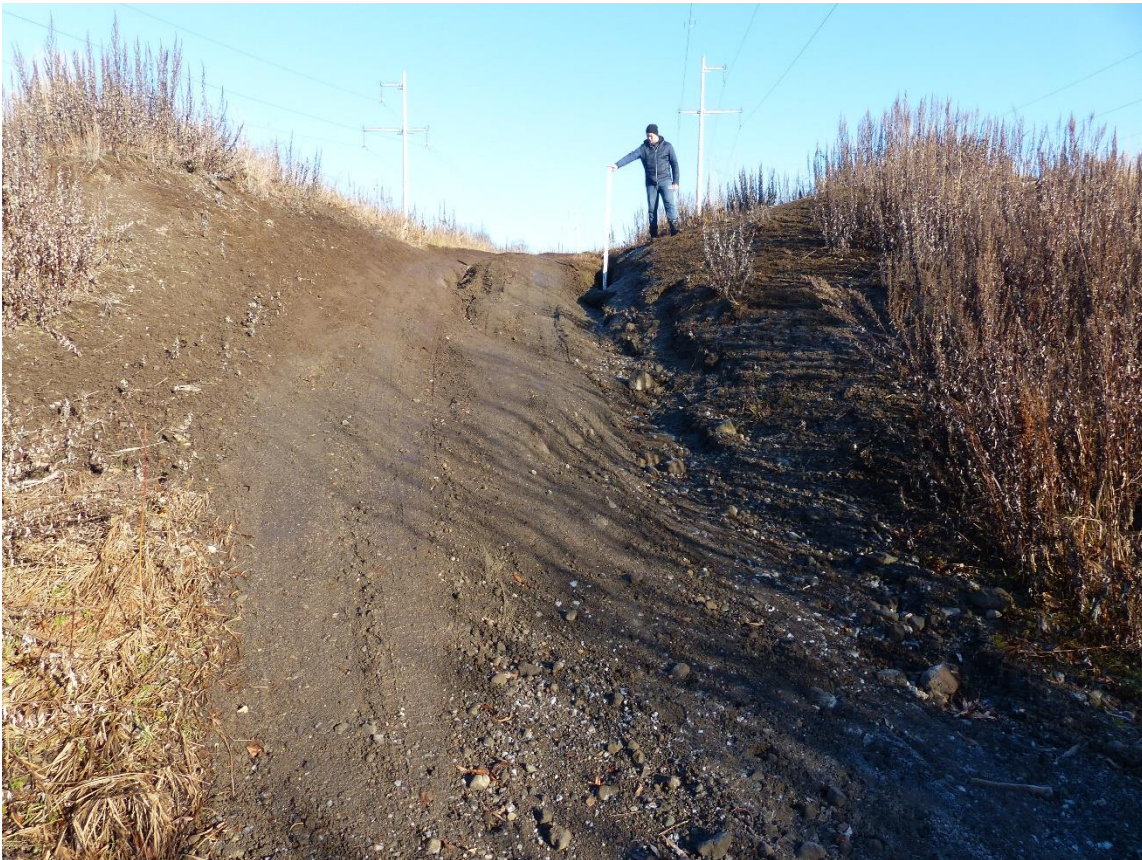
Рис. 21. Осмотр дорожной колеи. Вид с юго-запада.
