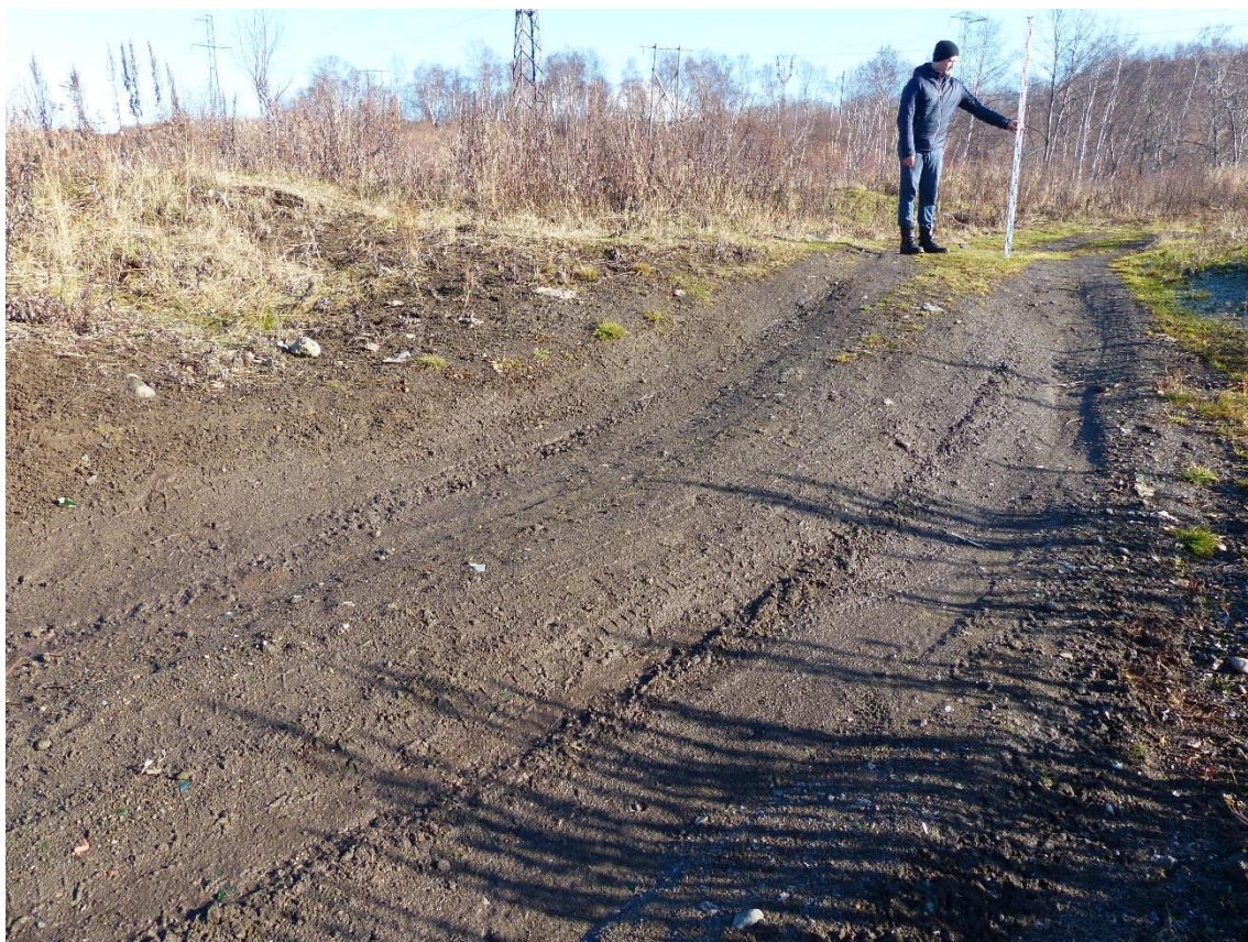
Рис. 22. Осмотр дорожной колеи. Вид с юго-запада.
