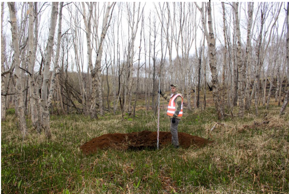
Рис. 29. «Объездная дорога от Петропавловское шоссе до жилого района «Северо-Восток». Строительство объездной дороги от проспекта Циолковского до Северо-Восточного шоссе (объезд Северо-Восточной части города)». Шурф № 3. Общий вид шурфа с выбранным заполнением (вид с юга).
